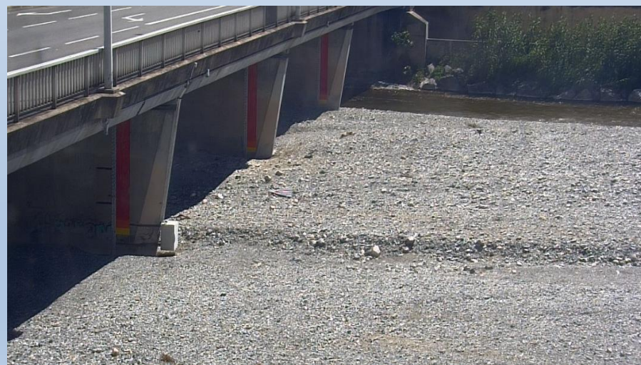
Surveillance vidéo / capteurs de niveaux d'eau sous les arches du fleuve Pailhon
