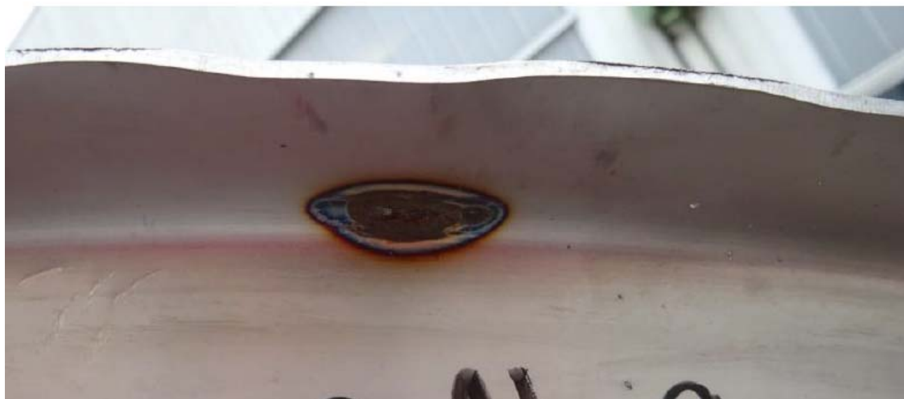
Figure 50. Accélérateur rompu – Silencieux ayant chuté - Côté hélice – Soudure 2.14a
