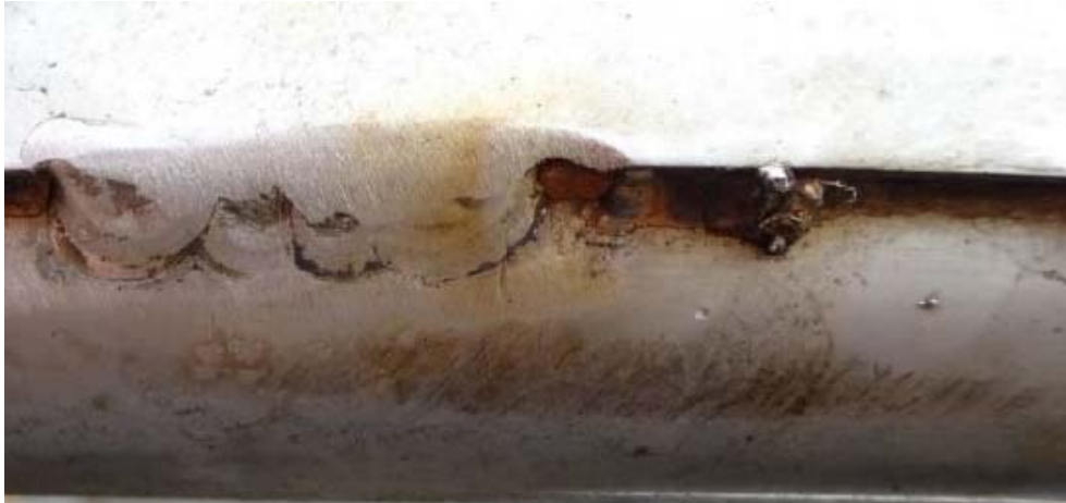
Cordon de soudure meulé, irrégulier
