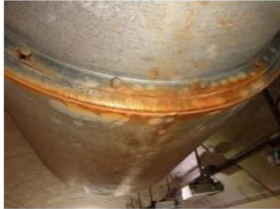
Figure 29 : Corrosion du revêtement extérieur et des soudures
