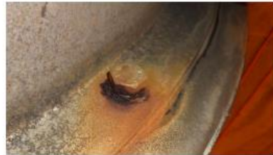
Figure 31 : Corrosion des boulons de l'accélérateur
