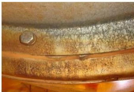
Figure 33 : décollement d'un joint d'étanchéité
