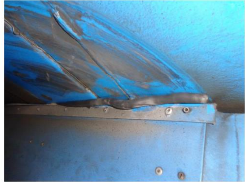
Figure 36 : joint registre partiellement arraché
