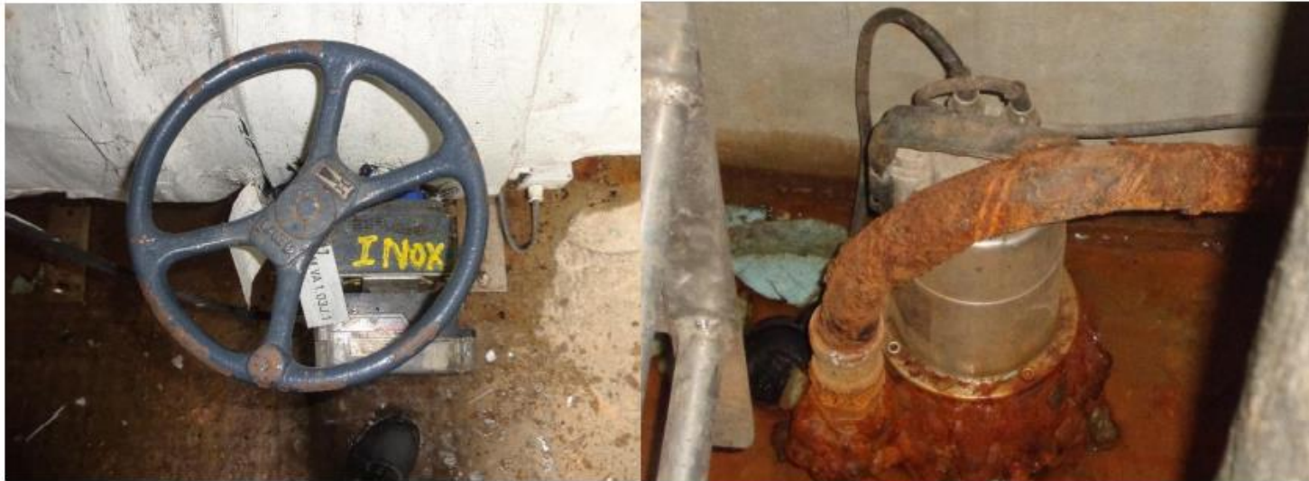
Figure 44 : corrosion avancée des équipements du bassin
