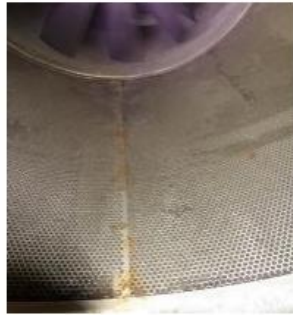
Figure 30 : traces de corrosion des silencieux
