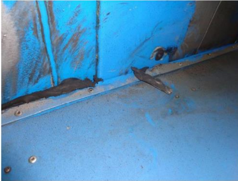
Figure 35 : joint registre déchiré
