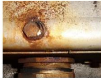
Figure 32 : Corrosion d'un boulon de boîtier des capteurs
