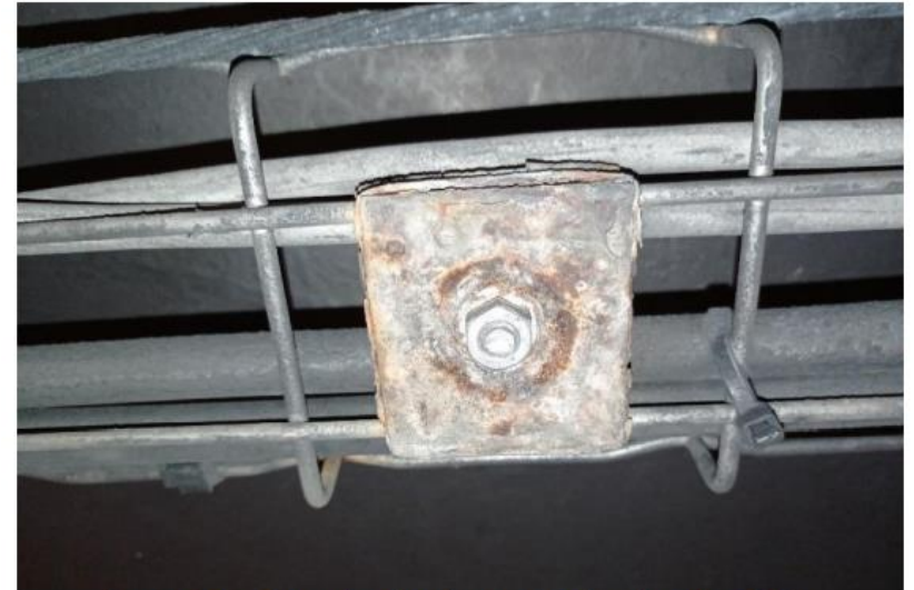
Figure 25 : Corrosion boulonnerie chemins de câbles
