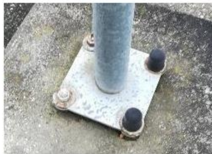
Figure 101 : Boulonnerie de fixation de feu R24 au niveau des barrières de fermeture
