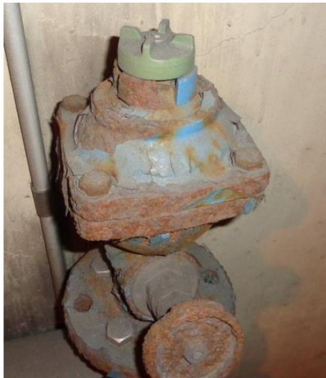
Figure 45 : corrosion avancée sur la ventouse
